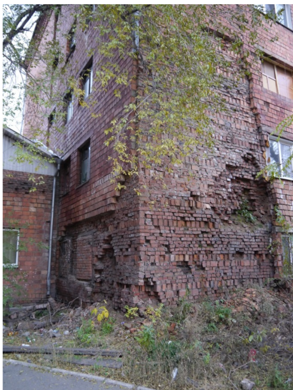
Фасад аварийного общежития, г. Черногорск, октябрь 2023 года
